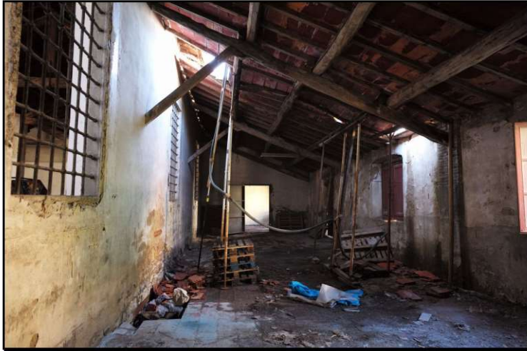
Foto n°3 (Strutture di copertura puntellate parte annessa)
