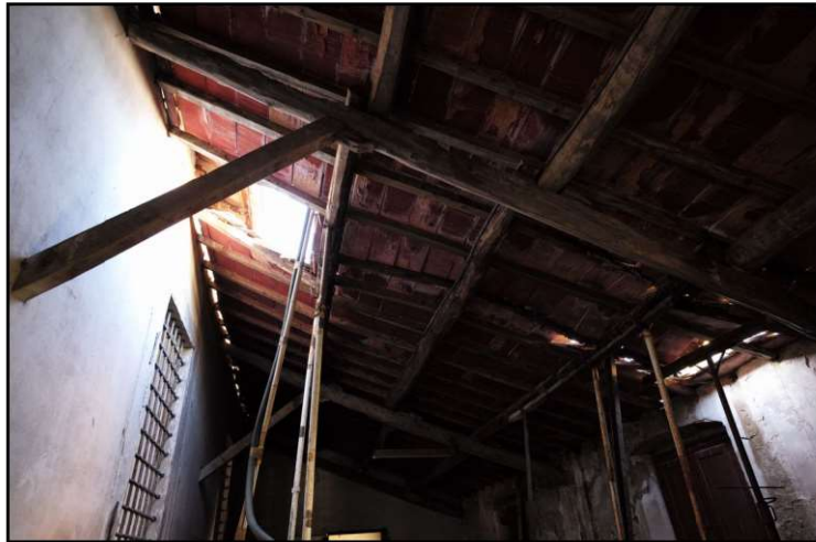
Foto n°2 (Strutture di copertura puntellate parte annessa)
